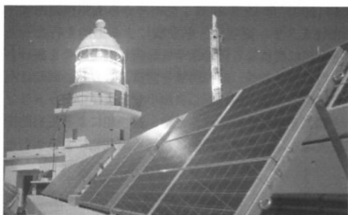
平成18年11月12日、クリーンなエネルギーである太陽光発電を利用した女島灯台の自動化整備が完了
